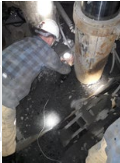
Zabudowa inklinometrów w warunkach dołowych.
